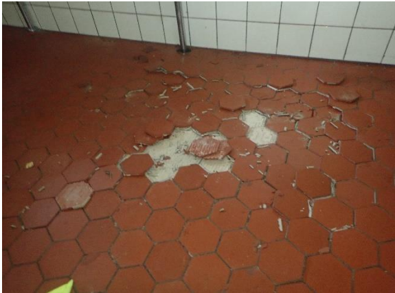
Kuva 5.13. Näyte 09, keittiön sosiaalitila. Lattialaatoitus ja laastit.
