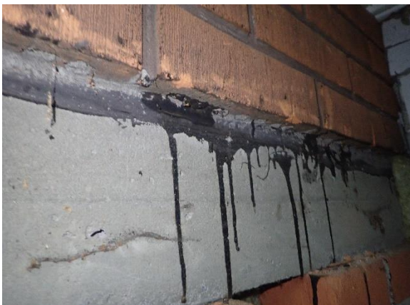
Kuva 5.15. Näyte 12, varasto. Entisen ulkoseinän pikisively.
