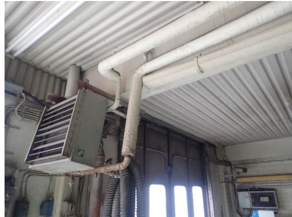
Kuva 5.4. Näyte 17, huoltohalli. Putkieristeet sisältävät asbestia.
