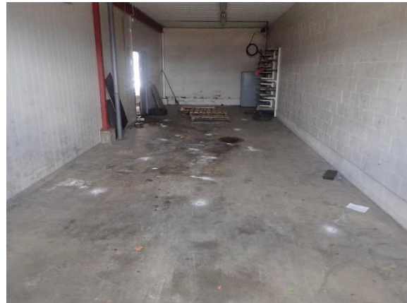
Kuva 5.24. Varasto- ja huoltohalli, laajennusosa. Näyte 14 ÖLJY.
