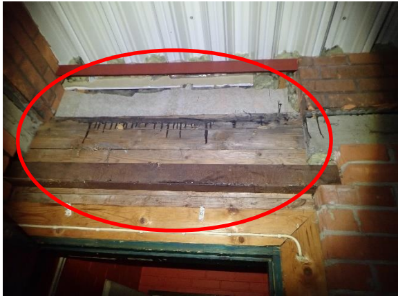
Kuva 5.3. Näyte 11, varasto. Oven yläpuolinen sementtikuitulevy sisältää asbestia.
