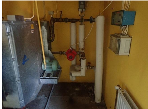
Kuva 5.6. IV-konehuone. Asbestia putkieristeissä.
