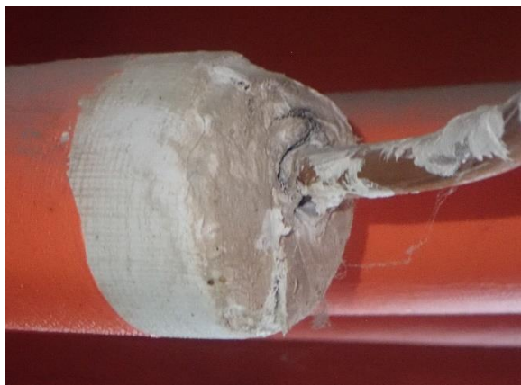
Kuva 5.1. Näyte 05, matkahuolto. Asbestia sisältävät putkieristeet.
