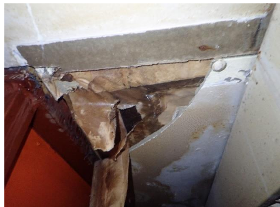
Kuva 5.2. Näyte 07, keittiö. Sisäkaton sementtikuitulevy sisältää asbestia.
