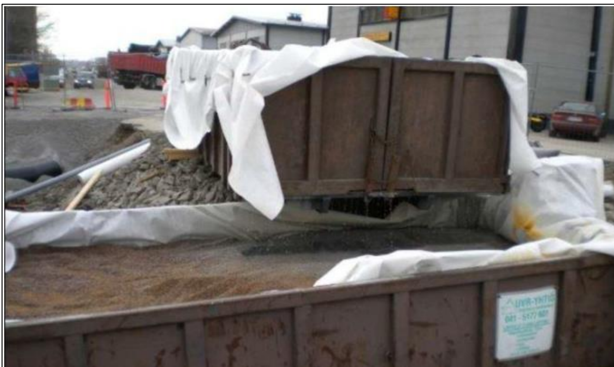
Kuva 19 Vaihtolavalla toteutettu hulevesien suodatus.
