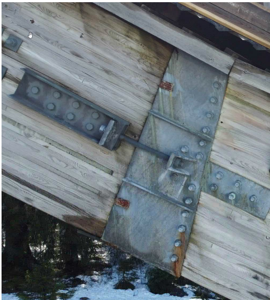
Kuva 43. Nivelliittimen tämänhetkinen kunto. Pohjalevyn hitsi on pettänyt.
