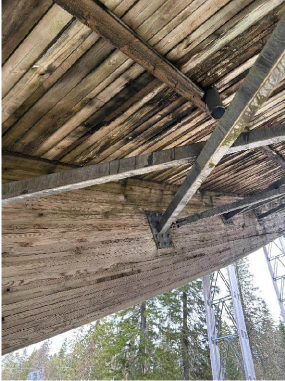
Kuva 5 Latualustalta tuleva ulosheittäjäputken ympärillä puurakenteissa on vedestä aiheutunutta värjäytymää.
