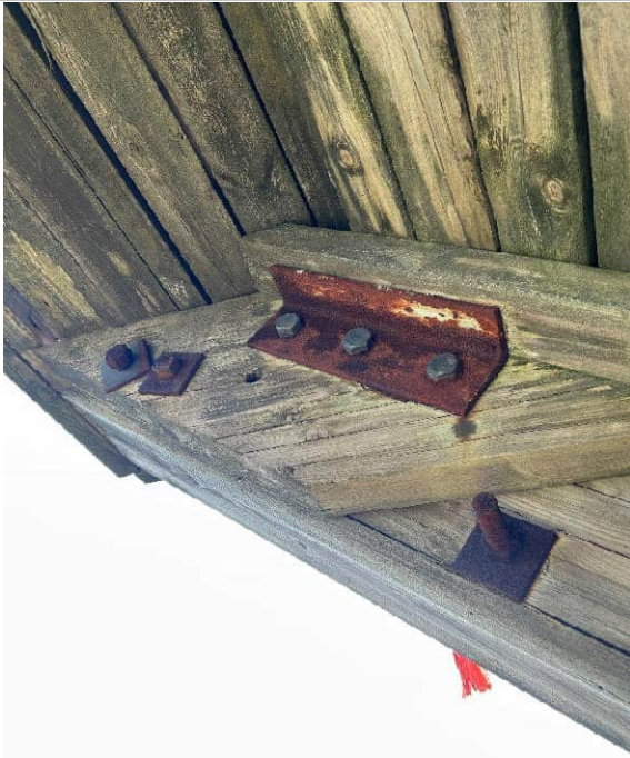
Kuva 21 Ruosteisia kiinnikkeitä ja teräsosia rakenteissa.
