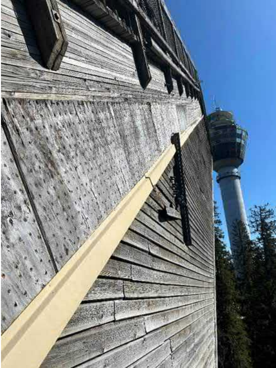
Kuva 14 Liimapuupalkkia tukeva vaneri on säälle alttiissa tilassa ja kunto on huonontunut. Puiset kaidetolpat ovat osittain haljenneet keskeltä. Paneloinnin ja liimapuun välissä oleva keltainen pellitys on huonosti kiinni alustassaan.
