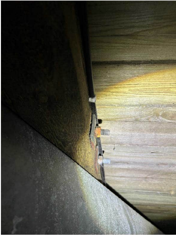
Kuva 25 Löysä läpikiinnityspultti, jossa on ruostetta.
