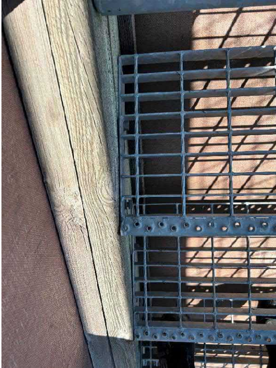
Kuva 26 Vauhtimäen molemmilla puolilla olevien metalliaskelmien kiinnitykset puurakenteisiin ovat löystyneet.
