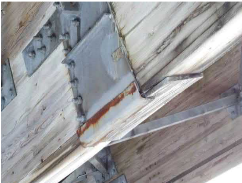
Kuva 9. Nivelliittimen kunto L2- ja L3-palkin välillä. Liitosta korjattu jälkikäteen.
