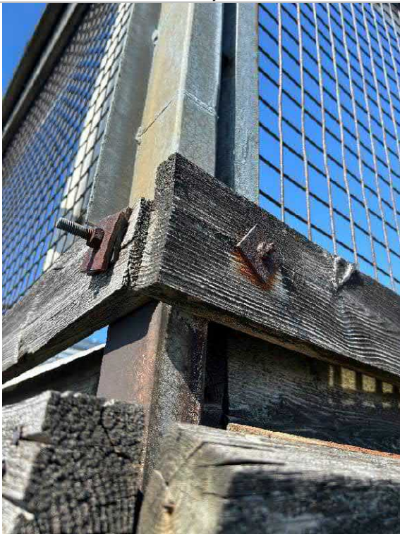
Kuva 23 Kaiteen ritilää tukevat puut ovat hapistuneet. Lautojen kiinnikkeissä on ruostetta.
