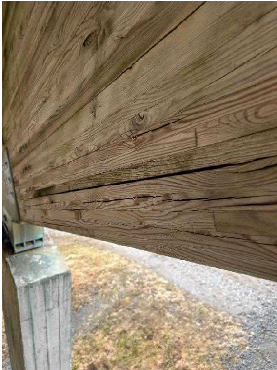
Kuva 9 Liimapuupalkeissa on halkeamia pääosin liimaussaumoissa.
