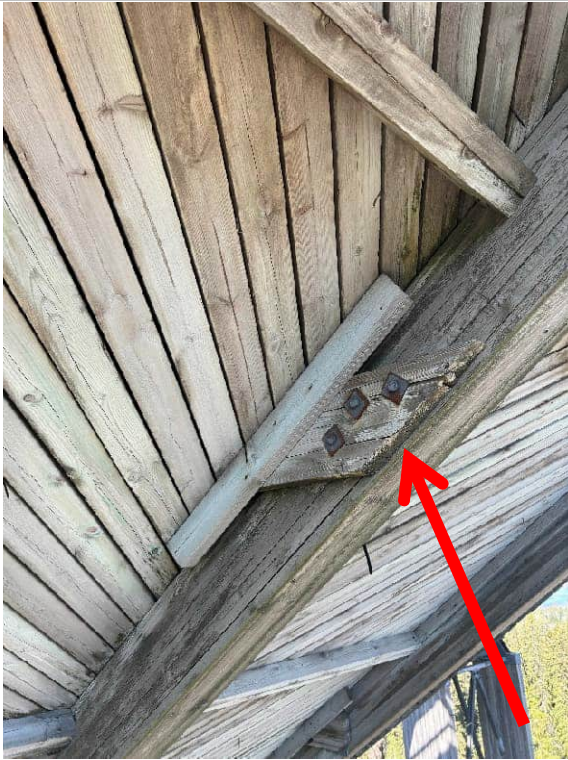
Kuva 17 Yläosan ulokerakenteen alapuolella olevissa liimapuutuissa on halkeamia.
