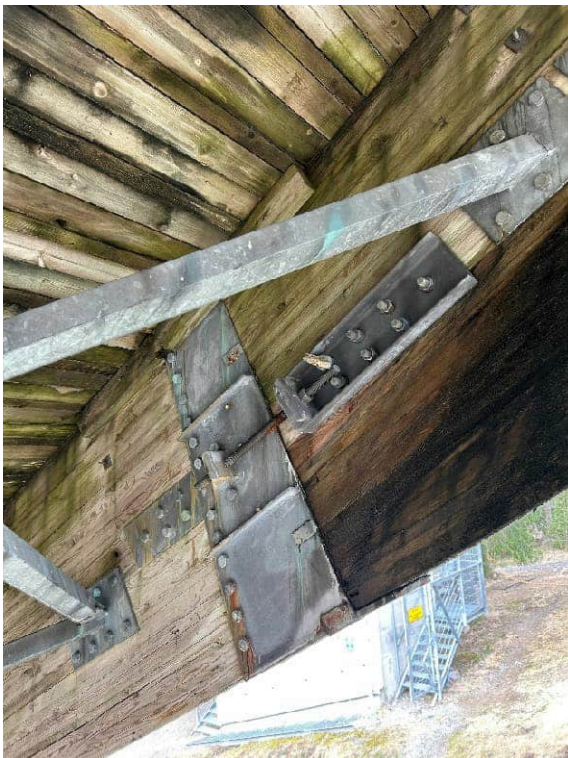
Kuva 7 Latualustalta tulevan poistoveden vuoksi puurakenne on niin märkä, että vesi tihkuu ruostevetenä pulttiliitoksista. Teräsrakenteessa on vetotanko.
