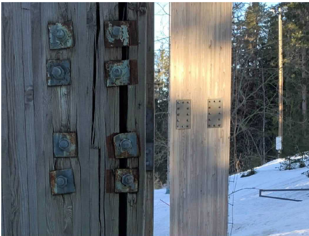
Kuva 2. Pääkannatinkehä (Puijon tornin puoleinen kehä) on erittäin vakavasti vaurioitunut
