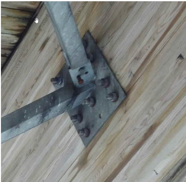
Kuva 8. Vaakaristikon liitokset ovat puutteelliset. Kuvassa toiminnassa vain yksi ruuvi.
