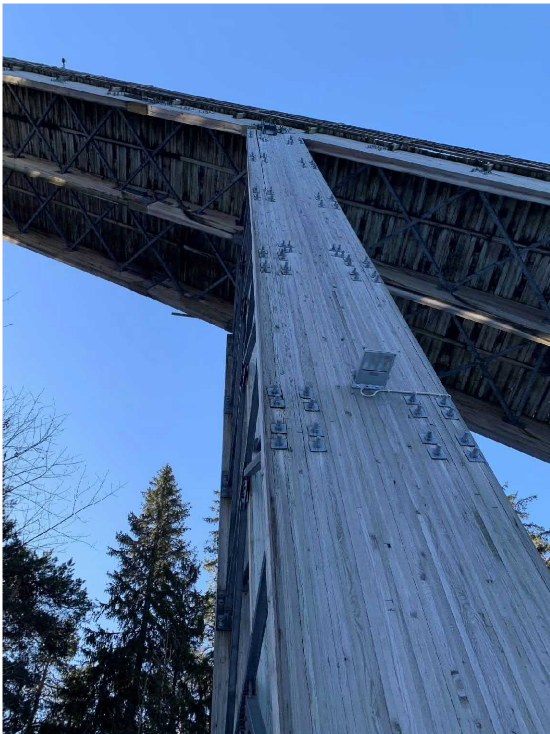
Kuva 5. Välikehän toinen puoli. Halkeamat ulottuvat ylös saakka.
