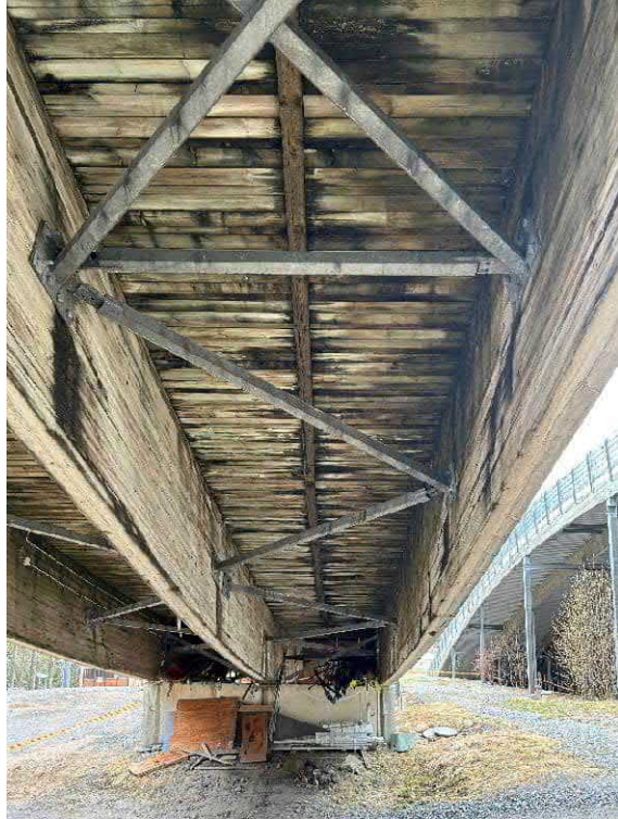
Kuva 2 Mäen alapuolisissa puurakenteissa on valumajälkiä.
