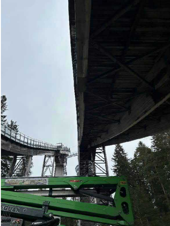
Kuva 1 Liimapuupalkeissa on havaittavissa vauhtimäen siirtymä etelään päin (kuvan katsomissuunnassa oikealla).
