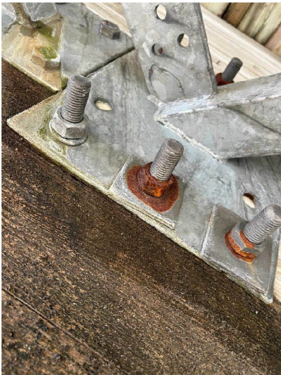
Kuva 3 Osassa pulttiliitoksissa on ruostetta.
