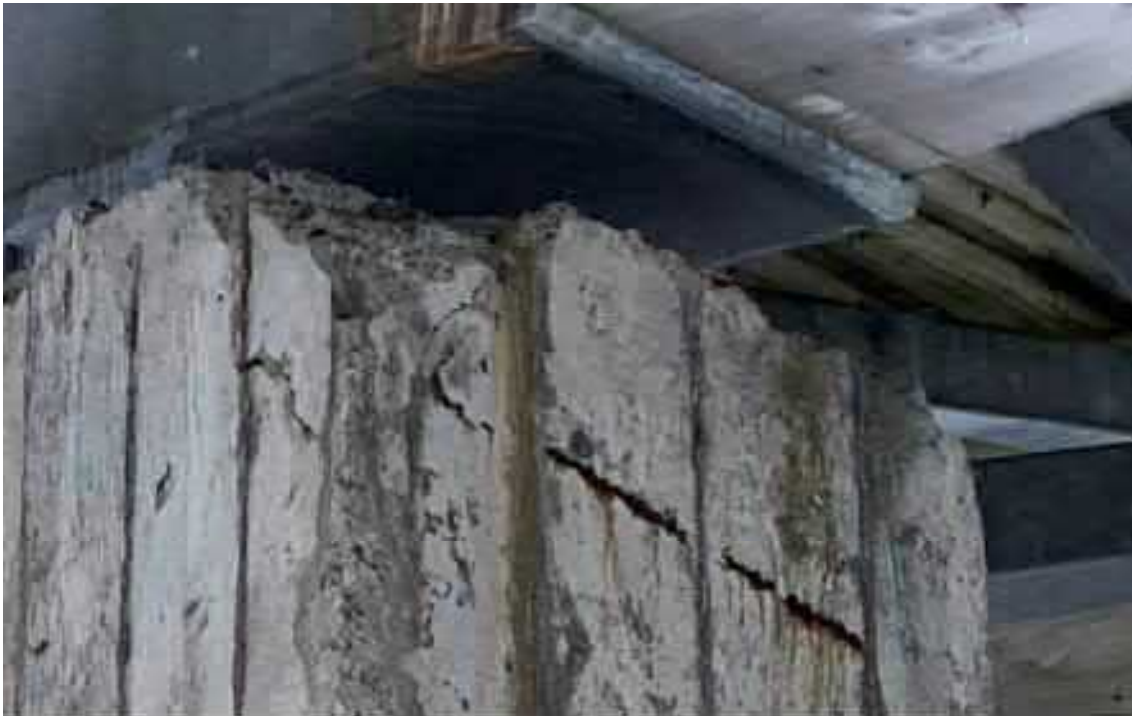
Kuva 10. Suurennos pilarin päästä. Ruostumisen aiheuttamia halkeamia.
