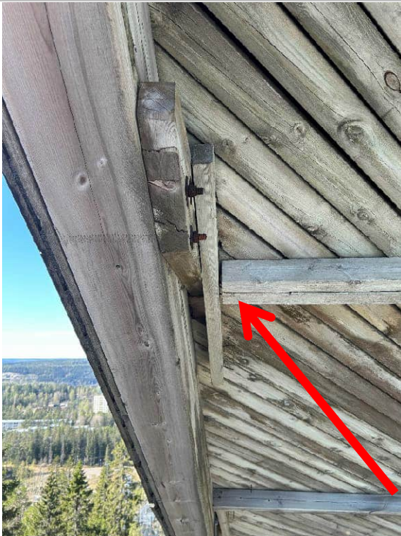
Kuva 19 Yläosan ulokerakenteen alalautoituksen välituen kiinnityksessä on puutteita. Rakenteiden väliin jää rako. Naulaliitosten nauloissa on ruostetta.
