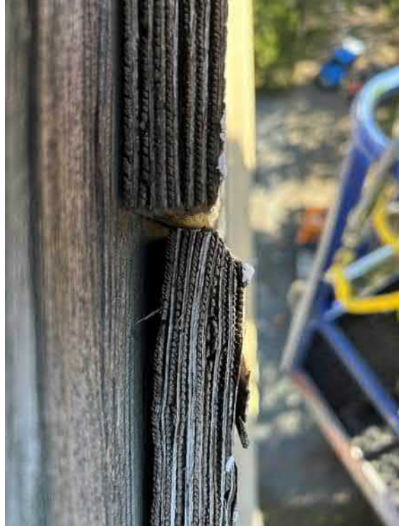
Kuva 15 Vaneri ei ole kiinni liimapuurakenteessa, välissä on rako. Vanerien kunto on huono.
