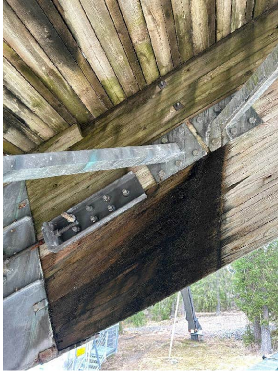
Kuva 6 Latualustalta tuleva poistovesi ohjautuu teräsrakenteiden kautta liimapuupalkeille.
