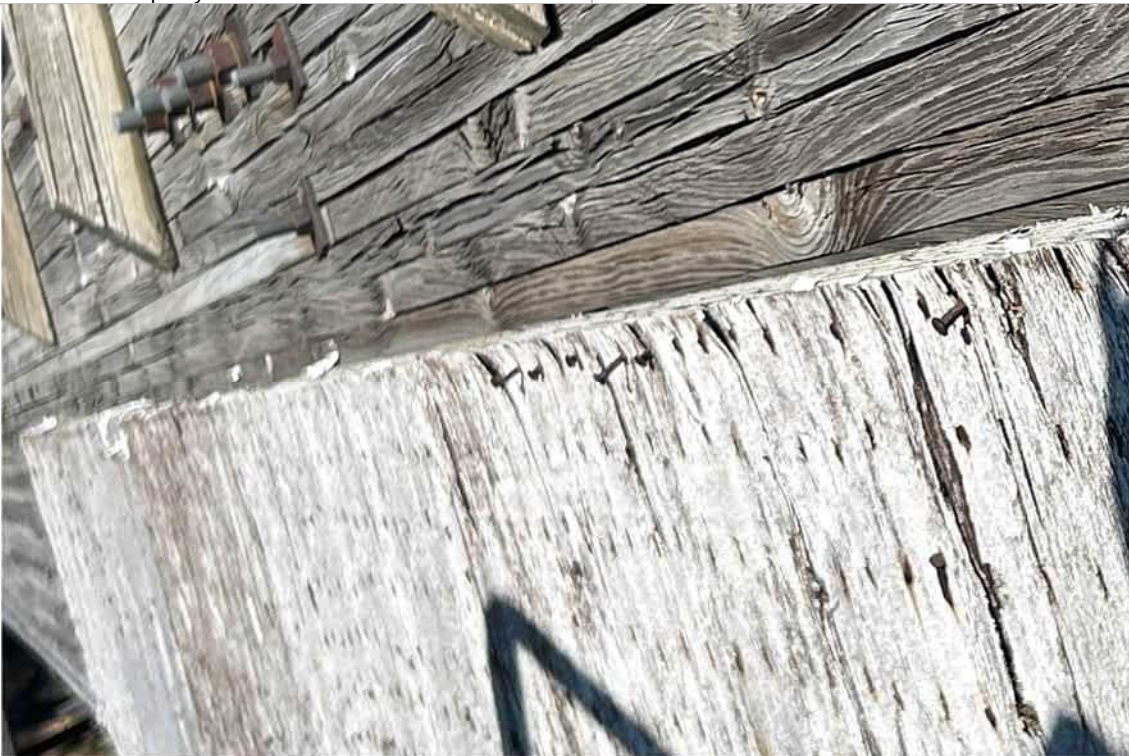
Kuva 16 Eteläpuoleiset vanerit irvistävät yläreunastaan ja kosteuseläminen on työntänyt ylintä naulariviä ylös
