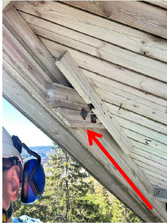
Kuva 18 Yläosan ulokerakenteen alapuolella olevissa liimapuissa on pahoja, puun läpi meneviä halkeamia pulttiliitoksen kohdalla. Pulttiliitos menettää kantokykynsä.
