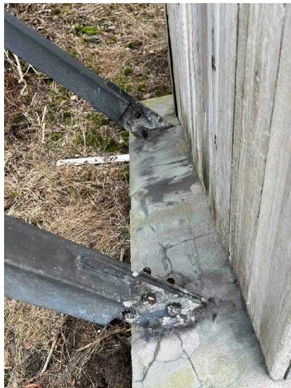
Kuva 12 Kuvassa takimmaisena olevasta pulttiliitokseta puuttuu puolet pulteista.
