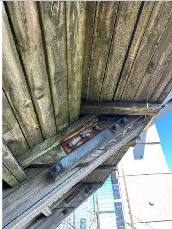
Kuva 20 Ulokkeen yläosassa olevissa kiinnityspulteissa ei ole aluslevyjä. Osa aluslevyistä on hitsattu rakenteeseen.
