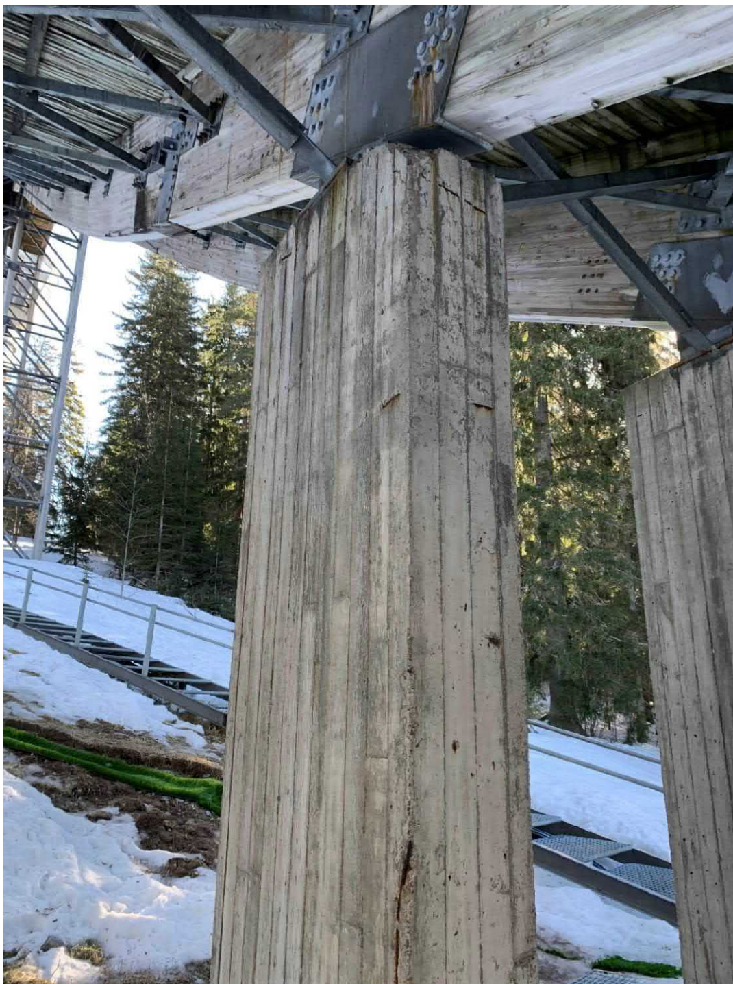
Kuva 9'. Teräsbetonipilarin raudoituksen peitesyvyys on riittämätön. Raudoitus on ruosteessa. Pilarin päässä on lohkeama.
