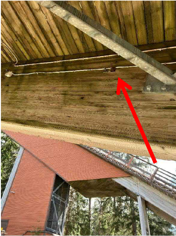
Kuva 13 Pienet läpikiinnitysten mutterit ovat löysällä.
