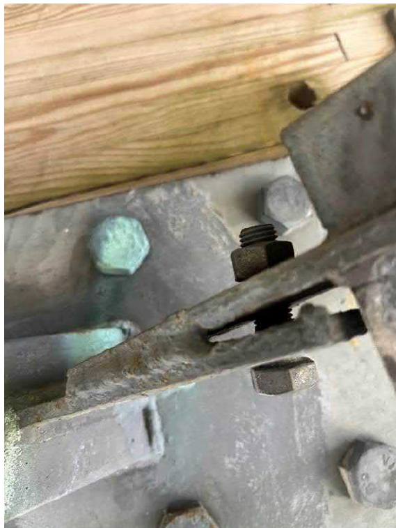
Kuva 4 Liitos, jossa on sekä hitsisaumaa, että pulttiliitos. Pulttiliitos on löysä. Johtuu siitä, että suunnitellulla rakenteella ei ole asennustoleranssia. Levyt eivät asennu toisiaan vasten. Voima siirtyy epäkeskisesti levyille aiheuttaen ylimääräisen rasituksen liitokselle.
