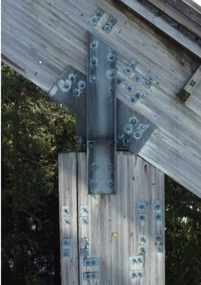
Kuva 10. Pilariryhmän 2 kohdalla liimapuupalkin ja pilarin väliin syntyy kontakti epäedulliseen paikkaan
