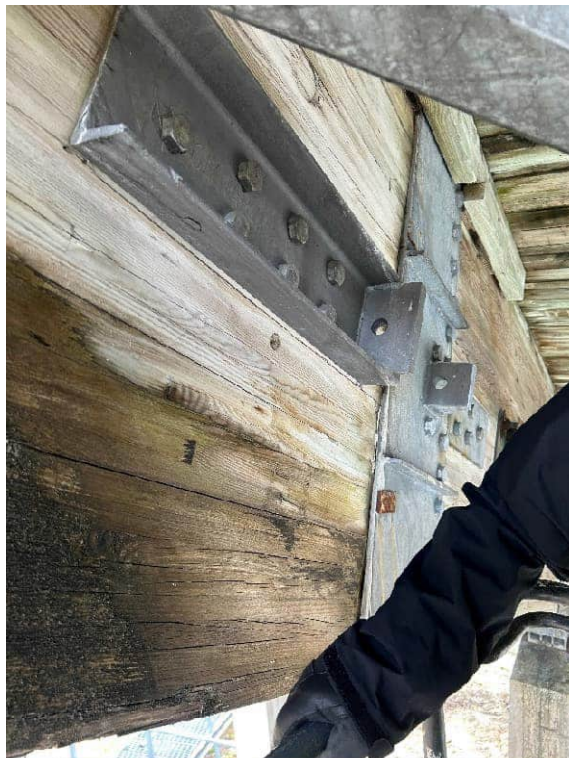
Kuva 8 Vastaavasti toisella puolella vetotanko puuttuu kokonaan.
