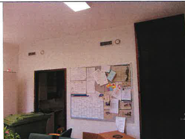
Kuva 21: Tulo- ja poistoveniilien sijainti neuvotteluhuoneessa
