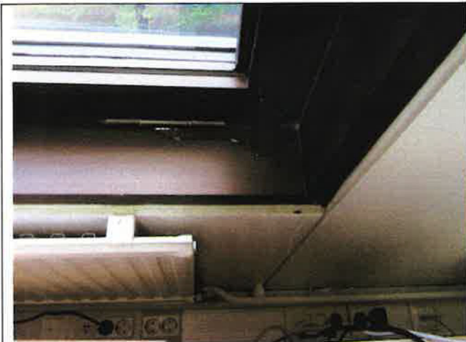
Kuva 15: Vettä tullut tuuletusikkunan tiivisteiden kautta ikkunapenkille tsto huoneessa
