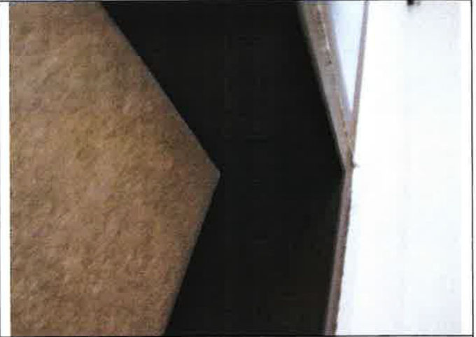
Kuva 6: Vuotojälkiä yläpuolella karmia oikealla puolella
