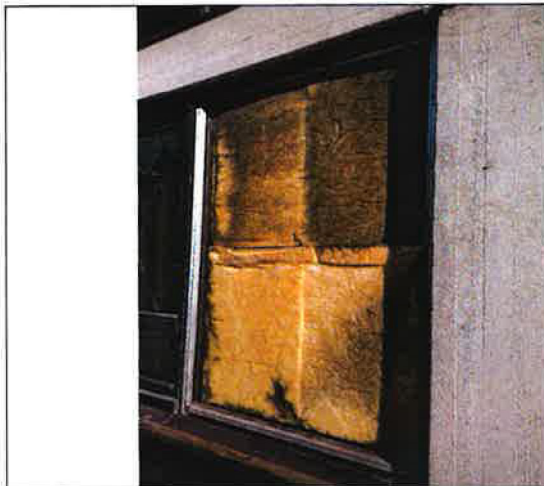
Kuva 31: Tuulensuojalevyn takaa havaitaan mineraalivillaeristeen pinnalla ilman epäpuhtauksista johtuvaa tummentumaa
