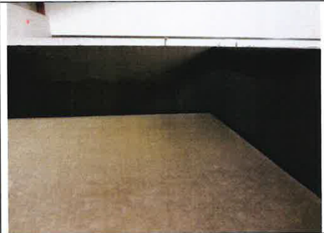
Kuva 14: Oikeassa yläreunassa on kosteuden tiivistymisen aiheuttamia valumajälkiä
