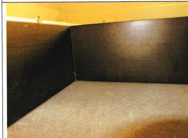
Kuva 13: Vasemmassa yläreunassa on sekä vesivuodon että kosteuden tiivistymisen aiheuttamia valumajälkiä
