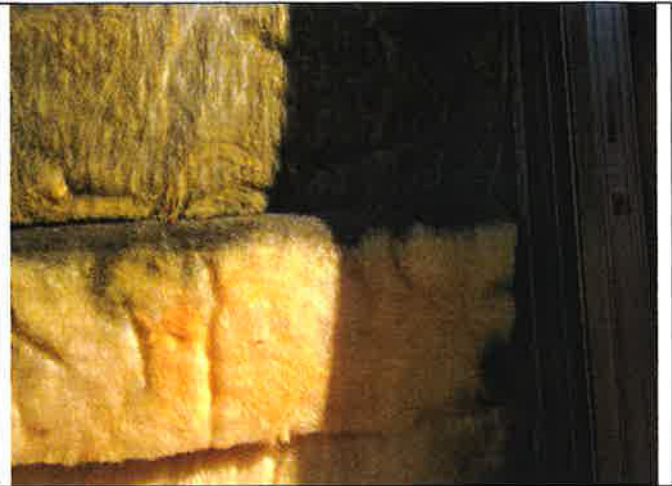
Kuva 32: Lämmöneristeen asennuksen virheitä, epätiiveyttä eristetilassa
