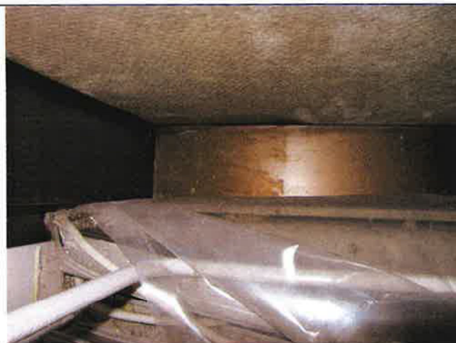
Kuva 3: Ulkopuolelta vuotaneen veden aiheuttamia jälkiä vasemmalla puolella seinää
