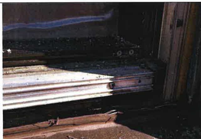
Kuva 29: Alareunan tiivisteiden epätiiveyden kautta pääsevä sadevesi pääsee valumaan ikkunapellityksen takaa rakenteisiin
