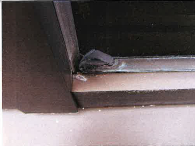
Kuva 27: Lasituksen tiivisteiden epätiiveyttä alareunassa
