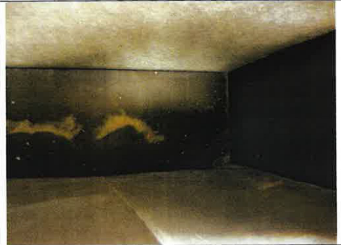
Kuva 12: Vesivuotojen valumajälkiä metalliseinän alaosassa oikealla puolella
