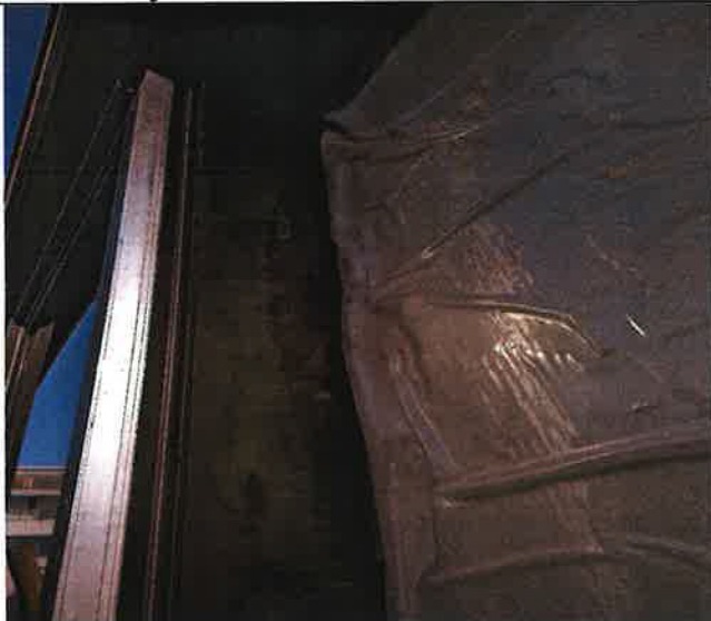
Kuva 33: Metallikehyksessä havaitaan kondensoituneen kosteuden aiheuttamia jälkiä höyrynsulun takana sisäpuolella
