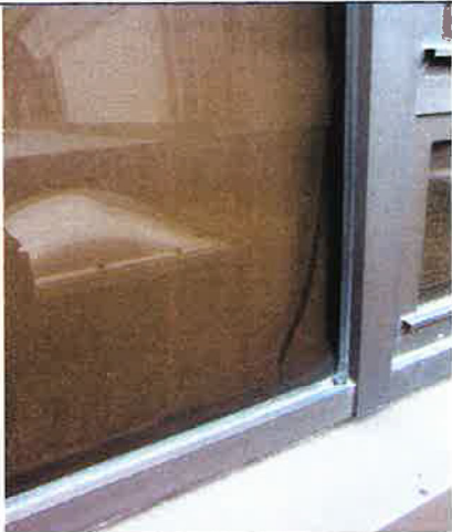
Kuva 25: Lasituksen takaa irronnut tiiviste
