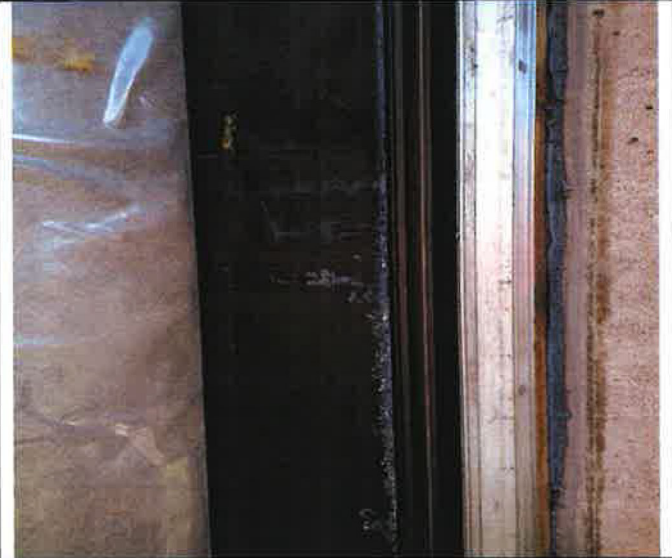
Kuva 34: Samaisen kehyksen ulkopinnassa lasituksen takana olevaa vesien valumajälkeä / hapettumista
