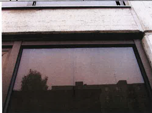
Kuva 35: Yläpuolelta vesipelleiltä sekä julkisivusta valuva vesi valuu lasitukselle, koska yläpuolen palkista puuttuu tippanokka
