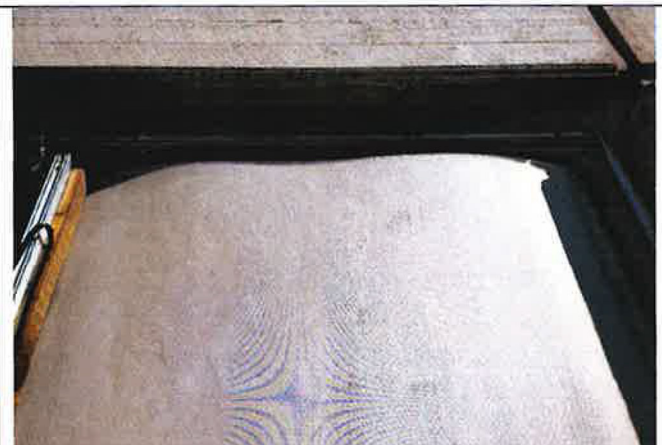
Kuva 30: Tuulensuojalevy on irronnut listan takaa kiinnityksistään lasituksen takana
