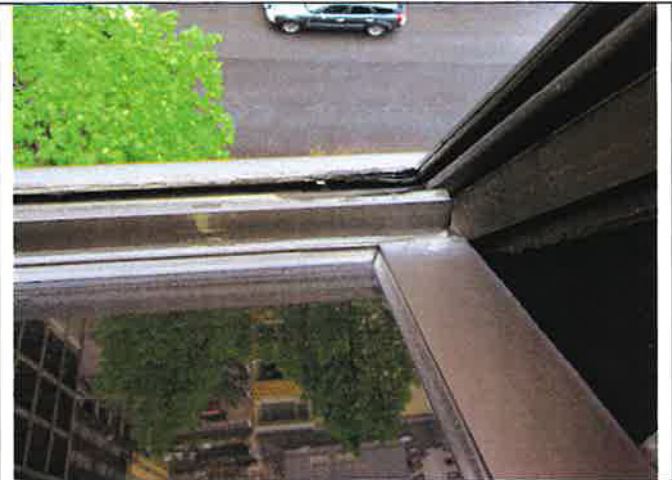
Kuva 16: Ikkuna avattuna huomataan tiivisteiden olevan rutussa vuotokohdalla
