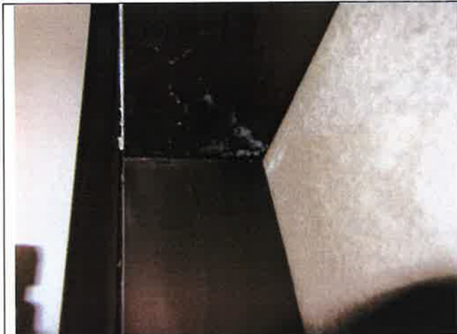
Kuva 5: Ulkopuolelta vuotaneen veden aiheuttamia valumajälkiä yläreunassa vasemmalla puolella
