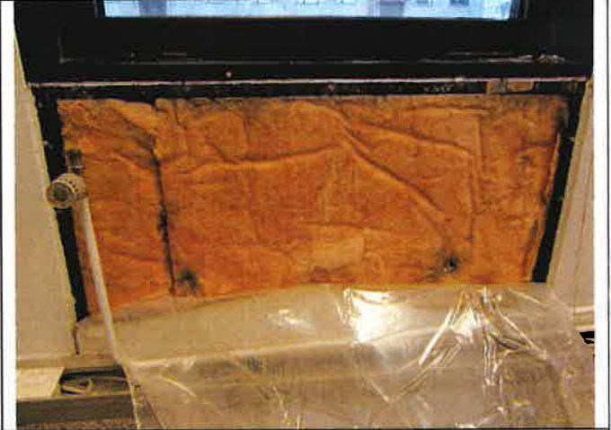
Kuva 8: Lämmöneristeet seinässä sisäverhouslevyn poiston jälkeen, eristeiden asennus on epätiivis
