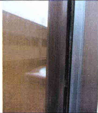
Kuva 26: Tiivisteiden irtoaminen mahdollistaa lasituksen painumisen ja ulkopuolisen tiivistyksen epätiiveyden
