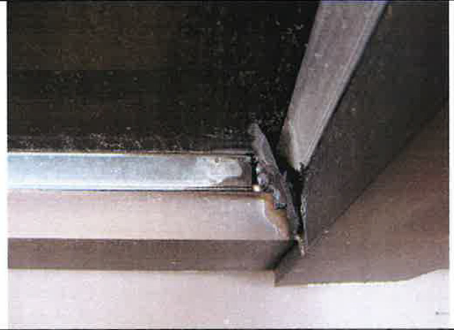
Kuva 28: Epätiiveyttä tiivisteissä toisaalla
