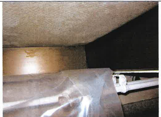
Kuva 4: Ulkopuolelta vuotaneen veden aiheuttamia jälkiä vasemmalla puolella seinää
