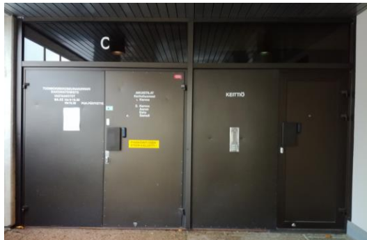
KUVA 73. Metallirakenteinen ulko-ovi C-osaan (Soininen 2017)
