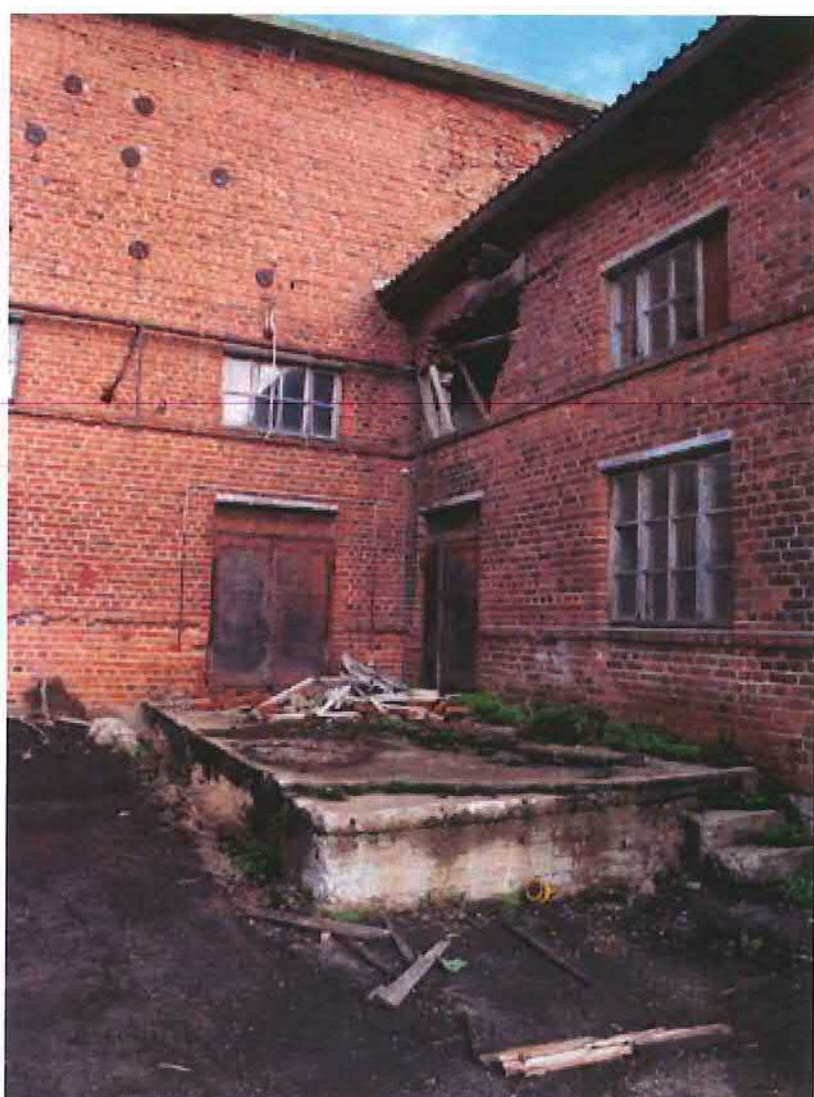
Ylinä kuitulevytehtaan läntistä julkisivua, alla eteläpään vaurioita. Oikealla kuitulevytehtaan 50-luvun teräsbetonisia kattorakenteita.
