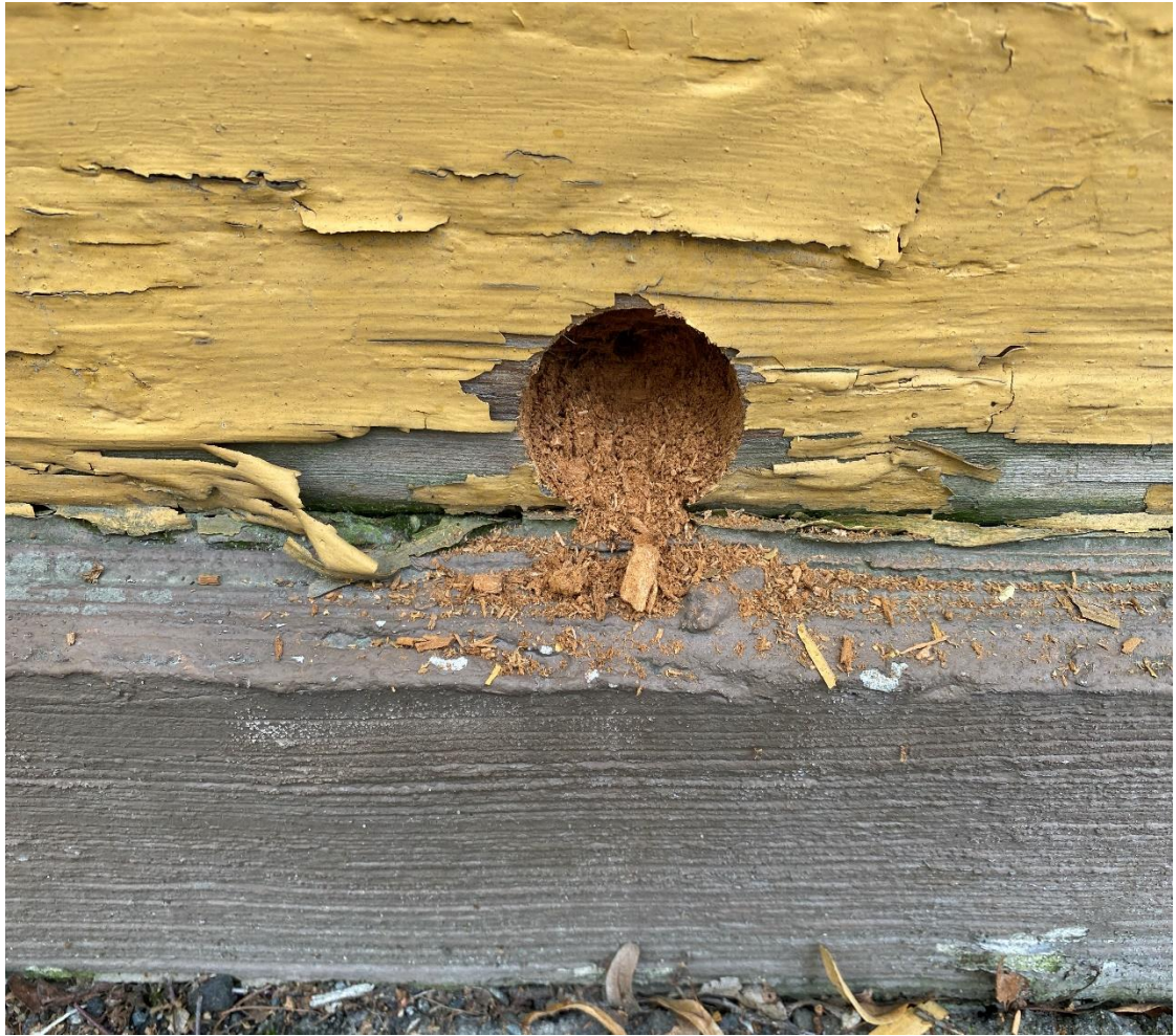
Kuva 26. Kuvasta on nähtävissä, että rakenneavauskohdassa julkisivulauta on täysin lahoa.
