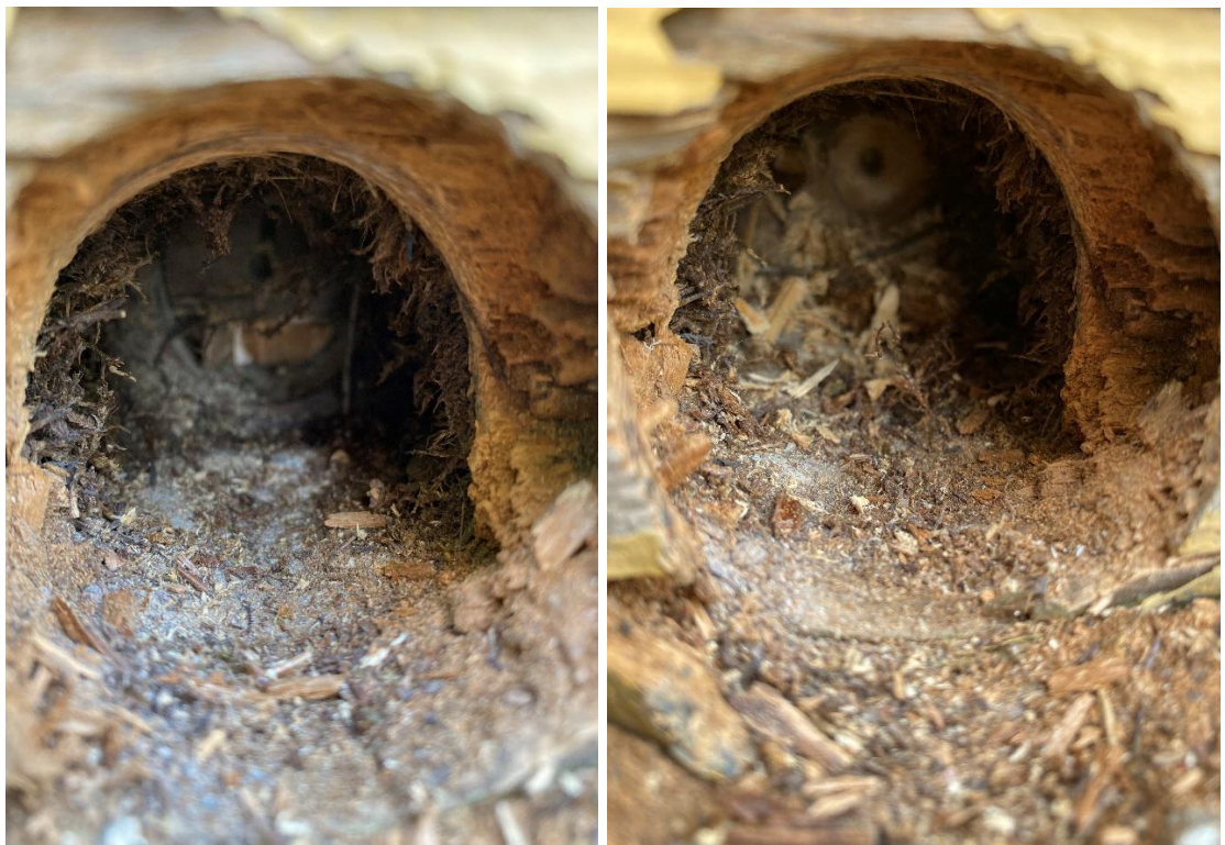
Kuvat 28 – 29. Vasemmanpuoleisessa kuvassa näkyy, että seinähirren pintakerroksessa selkeää värimuutosta n. 5-10 mm syvyydeltä. Oikeasta kuvasta on nähtävissä, että syvemmillä hirsi on paremmassa kunnossa.
