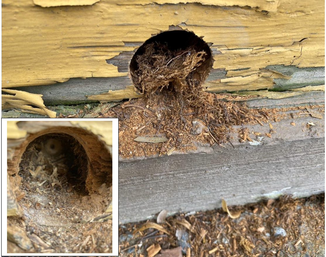
Kuva 27. Kuvassa näkyy julkisivulaudan takana oleva sammal/turvekerros. Katselmuksen tekijällä ei ole tarkkaa tietoa sammal/turvekerroksen merkityksestä, mutta arvioni mukaan sillä on voitu suojata hirsipintaa tai parantaa lämmöneristävyyttä.
