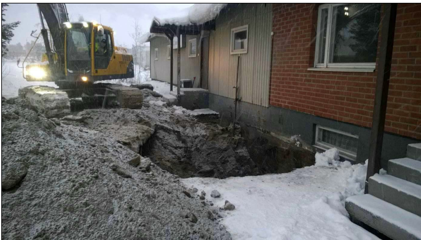
Kuva 4. Kuvassa ollaan kaivamassa lämmitysöljysäiliön viereen tehtyä koekuoppaa (KK8). Kuva on otettu länsiluoteen suunnasta.
