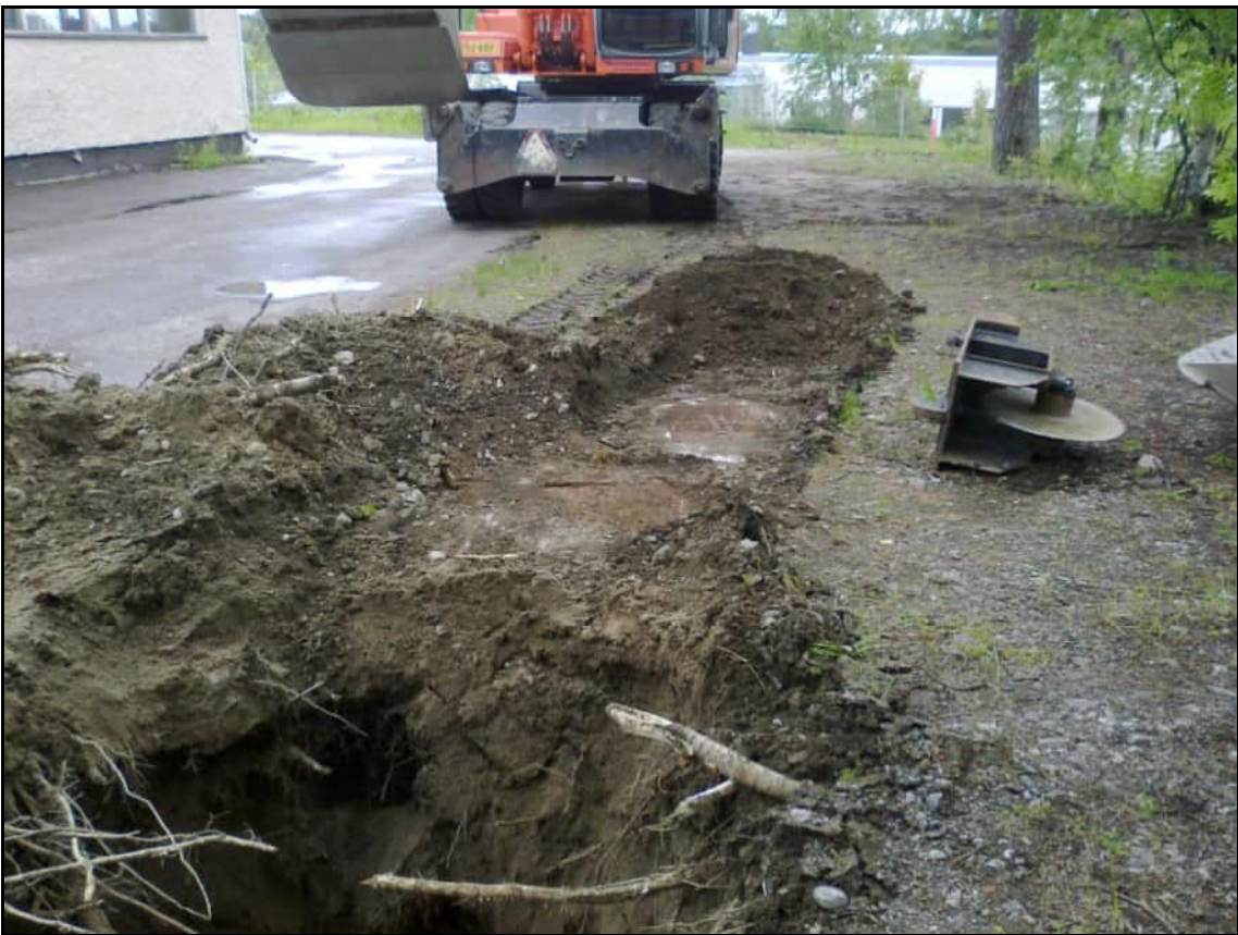
Kuva 4. Koekuoppa RF8 sekä maasta löydetty toinen saostuskaivo pyöröterän kohdalla.
