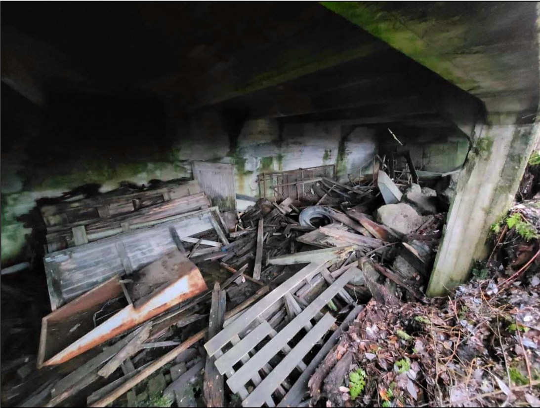
Kuva 9. Sekalaisia jätteitä ja rumua vanhan puretun rakennuksen kellarissa, kiinteistön keskiosassa.
