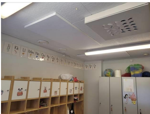
Kuva 4. Alakatot ovat alkuperäisiä. Ilmanvaihdon parannuksia on tehty korjausten yhteydessä 2007 ja 2013.
